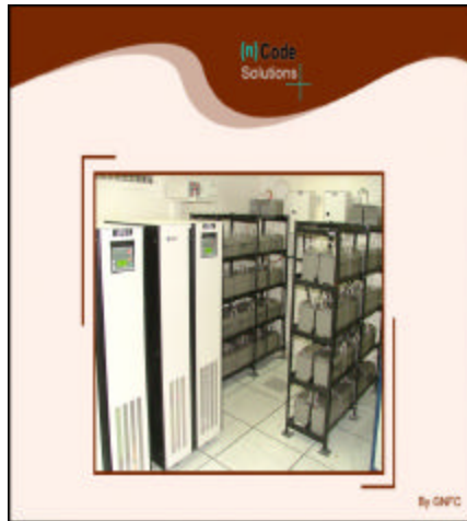
GNFC Data Center
