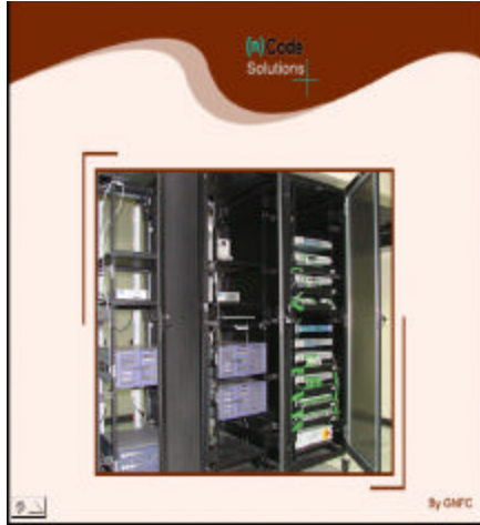
GNFC Data Center
